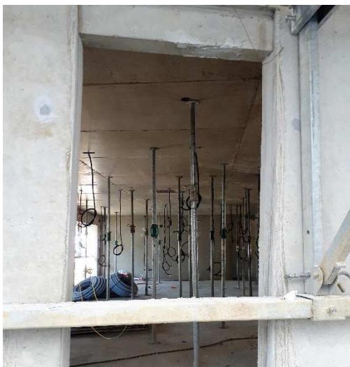
Aperçu des incorporations électriques
